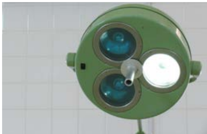
Figure 5.10 Une ampoule cassée, ce qui est très fréquent
